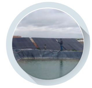
Sté Imazine « Casablanca » Système de pompage solaire
