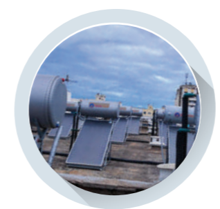
Polyclinique CNSS « Casablanca » Chauffe-eaux Solaires
