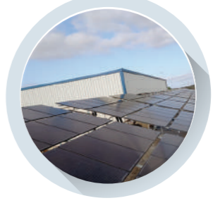
Sté Galvafil « Casablanca » Système Photovoltaïque couplé au réseau
