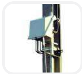
DISJONCTEUR HAUT POTEAU
